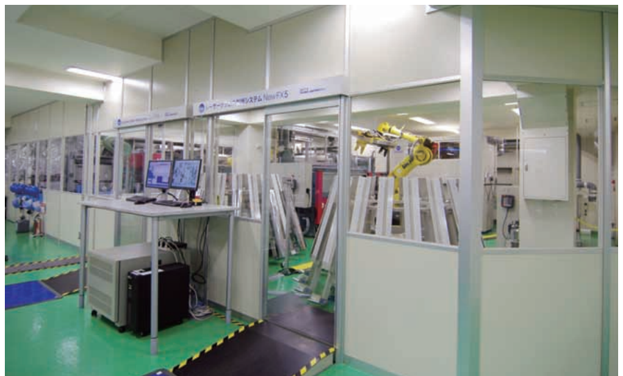
社内に設置されているNew FX5。全自動で日産120本の製版をこなす
